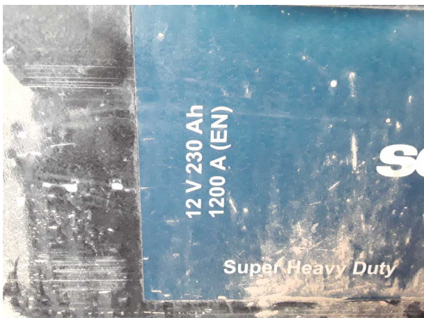
Beschädigung 7: elektrisches System: Batterie (Tiefenentladung) - defekt - erneuern
