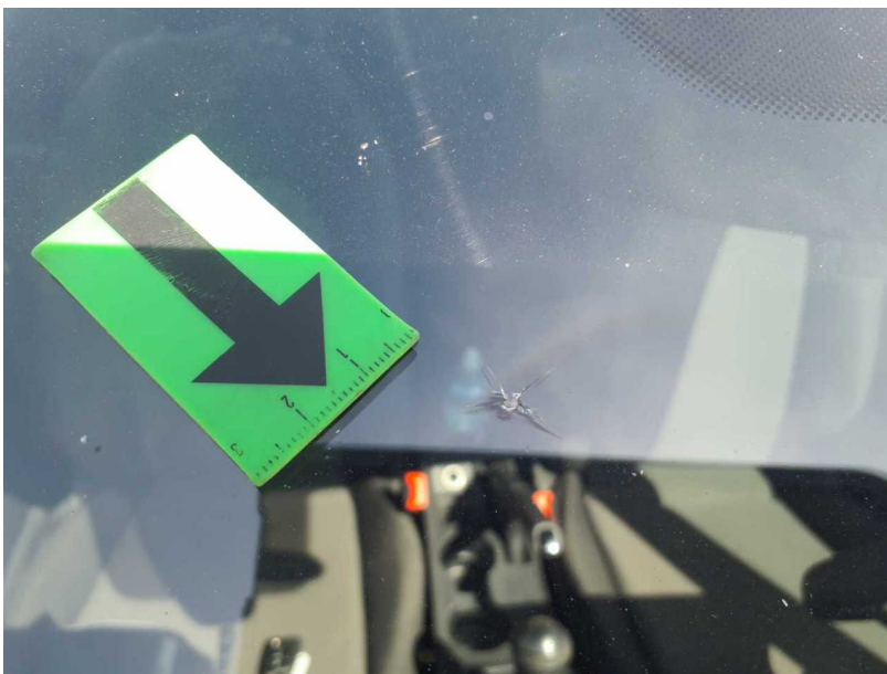
Beschädigung #4: Verglasung: Frontscheibe (Rissbildung) - Steinschlag - erneuern
