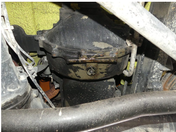
Beschädigung 10: Hinterachse: Differential - undicht - befunden ggf. instandsetzen
