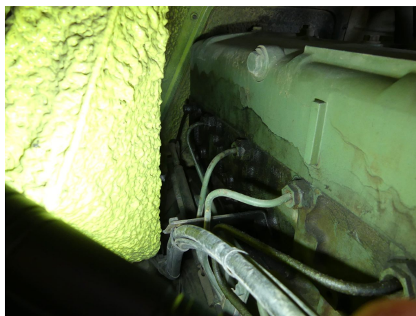
Beschädigung 13: Motor: Motor - undicht - befunden ggf. instandsetzen
