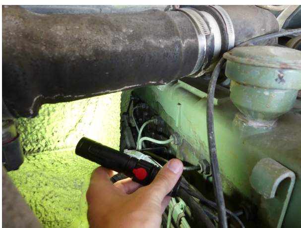
Beschädigung 13: Motor: Motor - undicht - befunden ggf. instandsetzen
