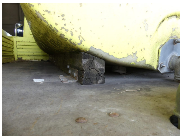
Beschädigung 5: Aufbau: Aufbau (Tank Fixierung) - porös / rissig - erneuern
