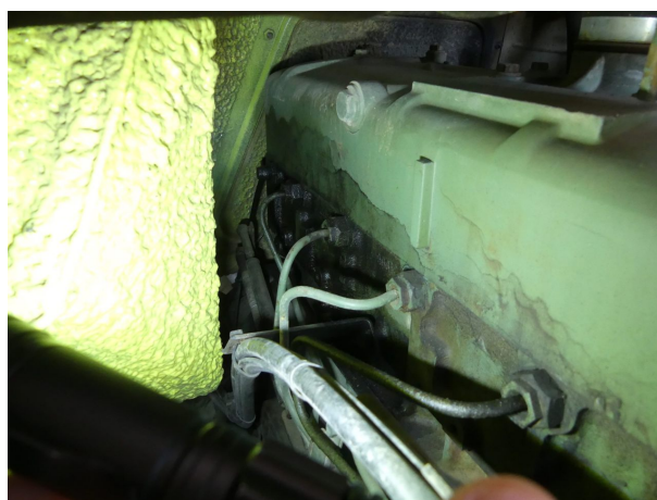
Beschädigung 13: Motor: Motor - undicht - befunden ggf. instandsetzen
