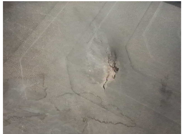
Beschädigung 3: Interieur: Innenraum - beschädigt
