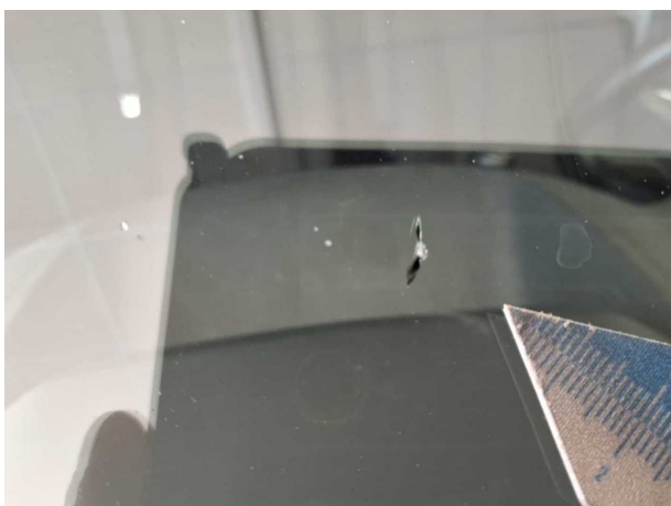
Beschädigung 3: Verglasung: Frontscheibe - gebrochen / gerissen - erneuern
