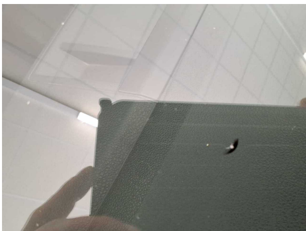
Beschädigung 3: Verglasung: Frontscheibe - gebrochen / gerissen - erneuern
