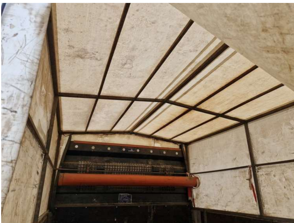
Viz popis k poškození č. 19
