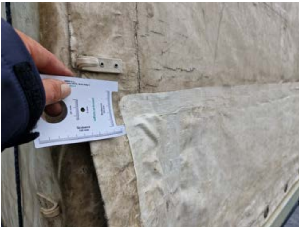
Viz popis k poškození č. 21
