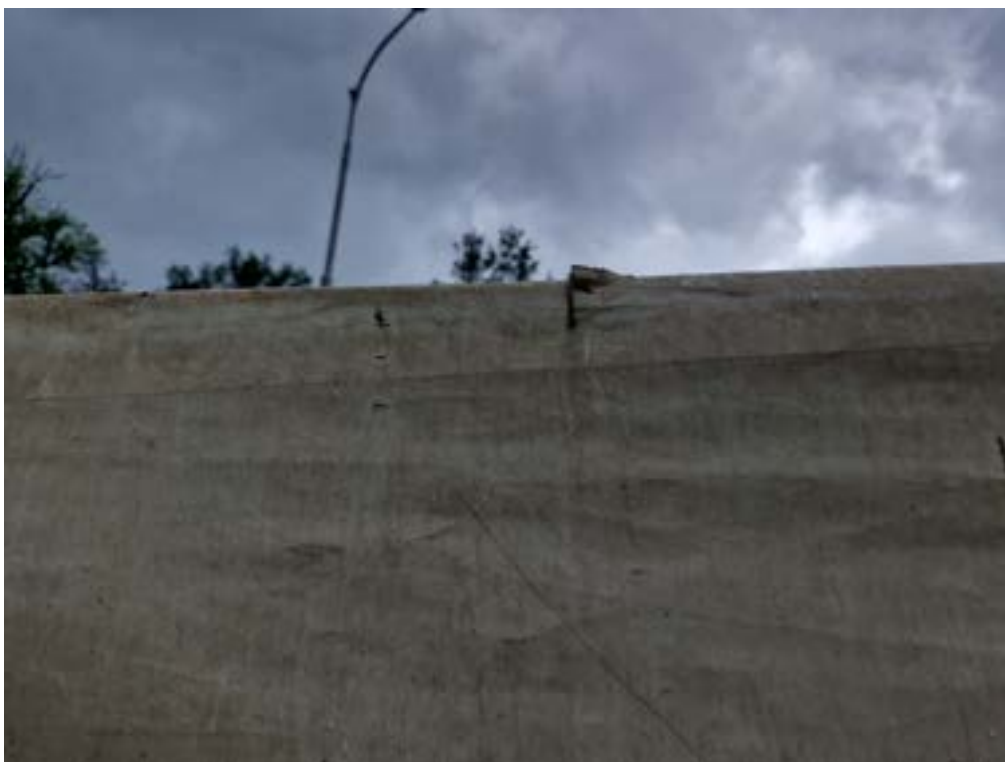
Viz popis k poškození č. 21
