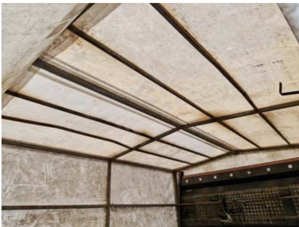
Viz popis k poškození č. 19
