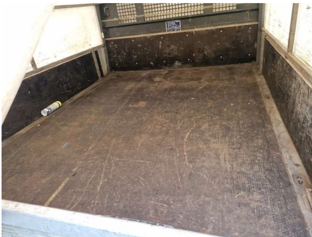
Viz popis k poškození č. 10
