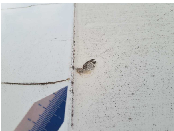
Beschädigung 4: Koffer: Seitenwand rechts - Löcher - instandsetzen
