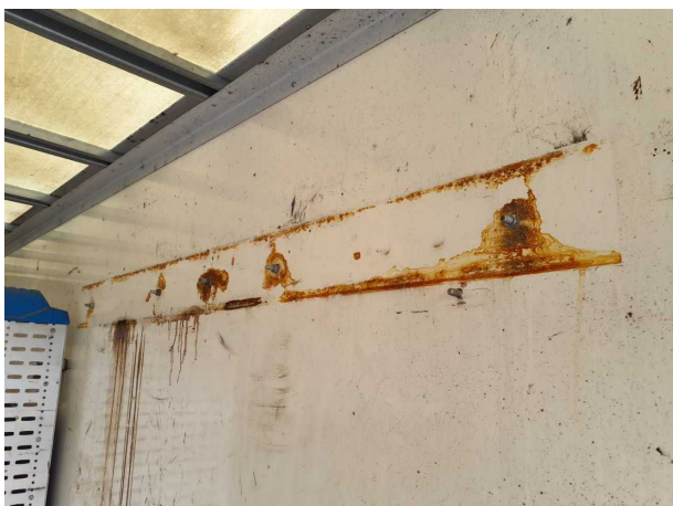
Beschädigung 4: Koffer: Seitenwand rechts - Löcher - instandsetzen
