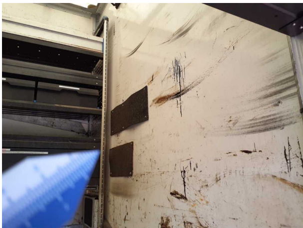
Beschädigung 7: Koffer: Stirnwand - Löcher - instandsetzen
