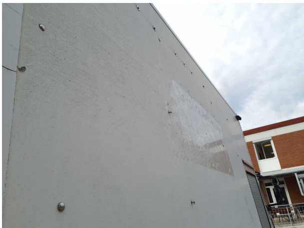
Beschädigung 4: Koffer: Seitenwand rechts - Löcher - instandsetzen
