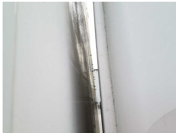
Beschädigung 7: Koffer: Stirnwand - Löcher - instandsetzen
