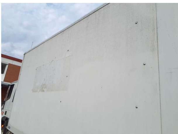
Beschädigung 3: Koffer: Seitenwand links - Löcher - instandsetzen
