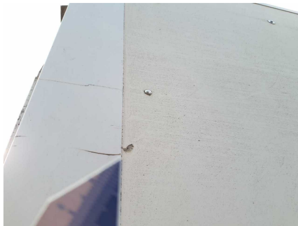
Beschädigung 4: Koffer: Seitenwand rechts - Löcher - instandsetzen
