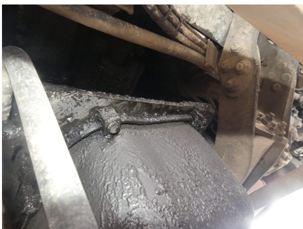
Beschädigung 11: Motor: Kurbelgehäusejoch (Getriebe) - undicht - instandsetzen
