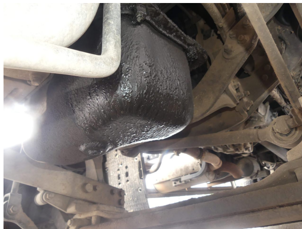
Beschädigung 11: Motor: Kurbelgehäusejoch (Getriebe) - undicht - instandsetzen
