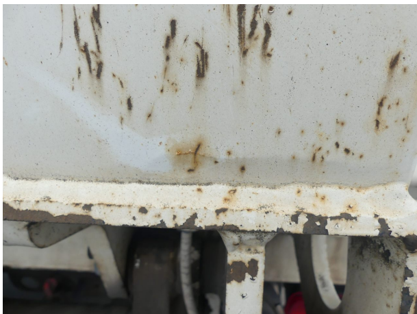
Beschädigung 10: Ladebordwand: Ladebordwand - gebrochen / gerissen - erneuern
