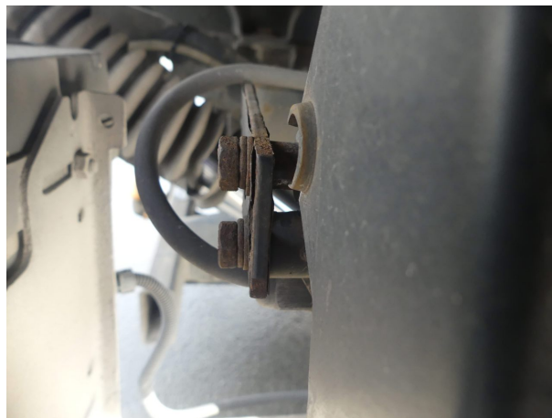
Beschädigung 5: Ladebordwand: Handbedienteil (Deckel) - gebrochen / gerissen - erneuern
