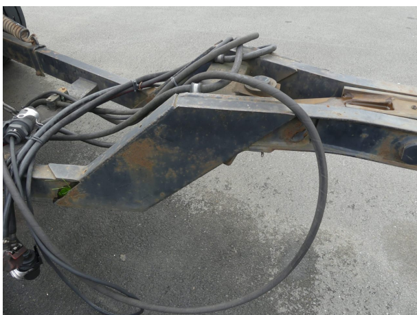
Beschädigung 1: Rahmen: Rahmen - Korrosion - instandsetzen und lackieren
