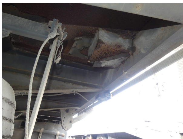
Beschädigung 1: Rahmen: Rahmen - Korrosion - instandsetzen und lackieren
