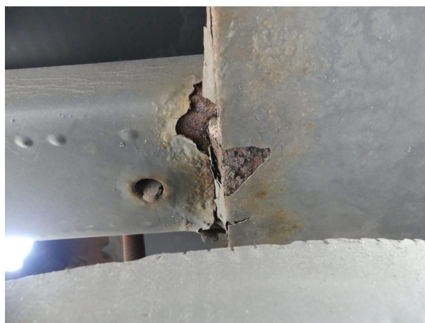
Beschädigung 1: Rahmen: Rahmen - Korrosion - instandsetzen und lackieren
