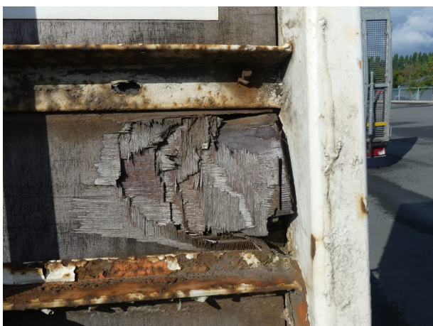
Beschädigung 7: Rahmen: Rahmen (Auffahrrampe) - gebrochen / gerissen - instandsetzen
