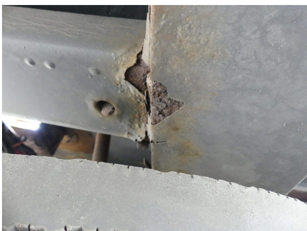
Beschädigung 1: Rahmen: Rahmen - Korrosion - instandsetzen und lackieren
