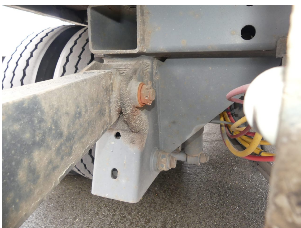
Beschädigung 3: Rahmen: Rahmen (Scherenbolzen) - lose - instandsetzen
