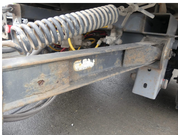
Beschädigung 1: Rahmen: Rahmen - Korrosion - instandsetzen und lackieren
