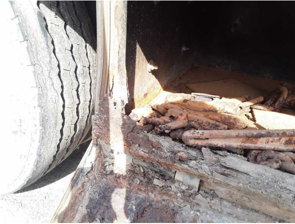
Beschädigung 4: Rahmen: Rahmen (Staukasten durchgerostet) - erneuern
