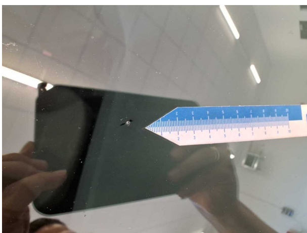
Beschädigung 3: Verglasung: Frontscheibe - gebrochen / gerissen - erneuern
