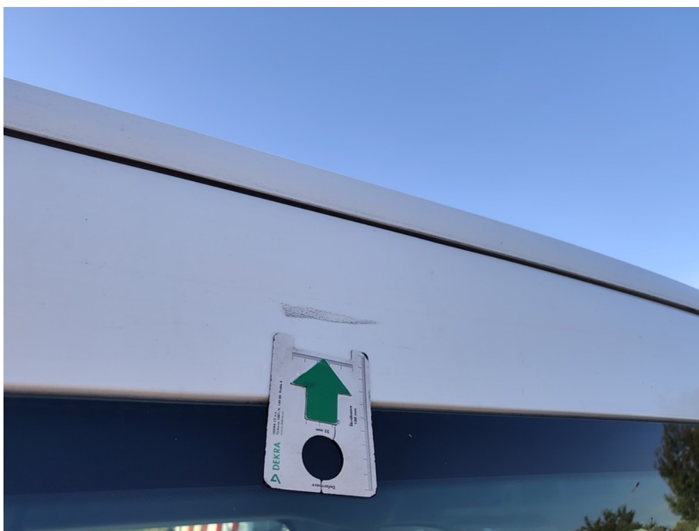
Viz popis k poškození č. 5
